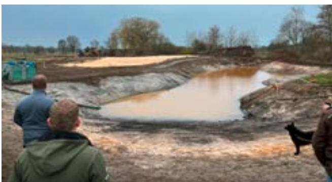
Bei der abschließenden Platzbesichtigung gab es Einblicke in die Platzpflege und in den Umbau von Grün A3, ...
