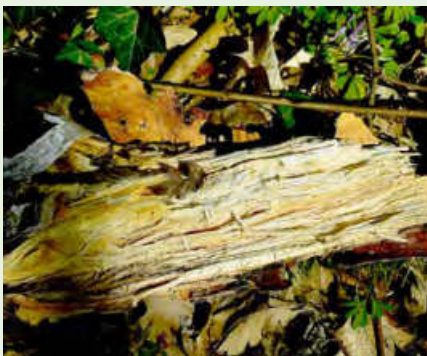
Abb. 20: Der Stämmling einer Eiche zeigt im Splintholz deutlich Weißfäule; das Kernholz ist nicht betroffen.
