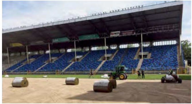
In nur acht Wochen wurde die Rasenfläche saniert und die Regenwassernutzungsanlage installiert. (Foto: Stadt Mannheim)
