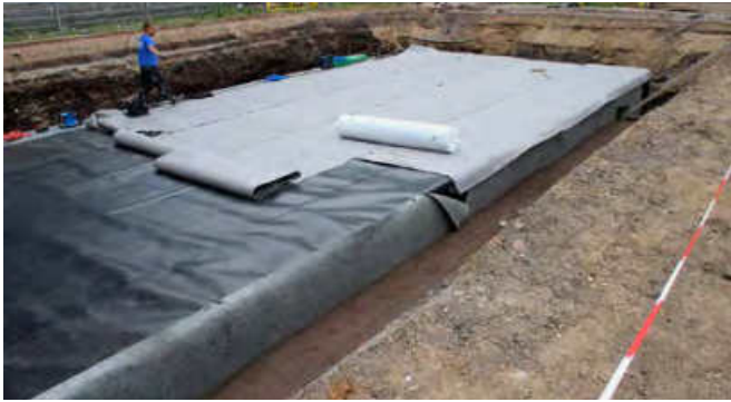
In einem dritten Arbeitsschritt wurde die Rigole nochmals mit dem Geotextil umschlossen.
