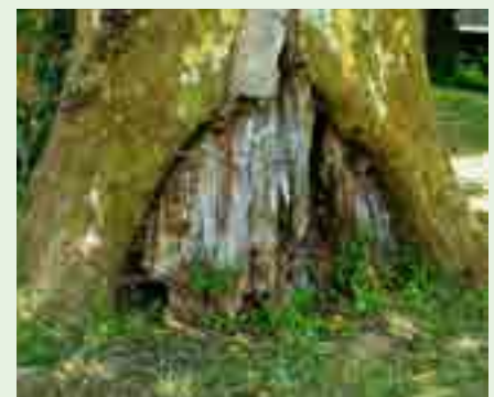
Abb. 20: Große offene Morschung am Stammfuß. Zu prüfen ist die verbliebene Wandstärke und wie weit die Fäule bereits fortgeschritten ist. Das Ausmaß der Höhlung ist zu vermessen.
